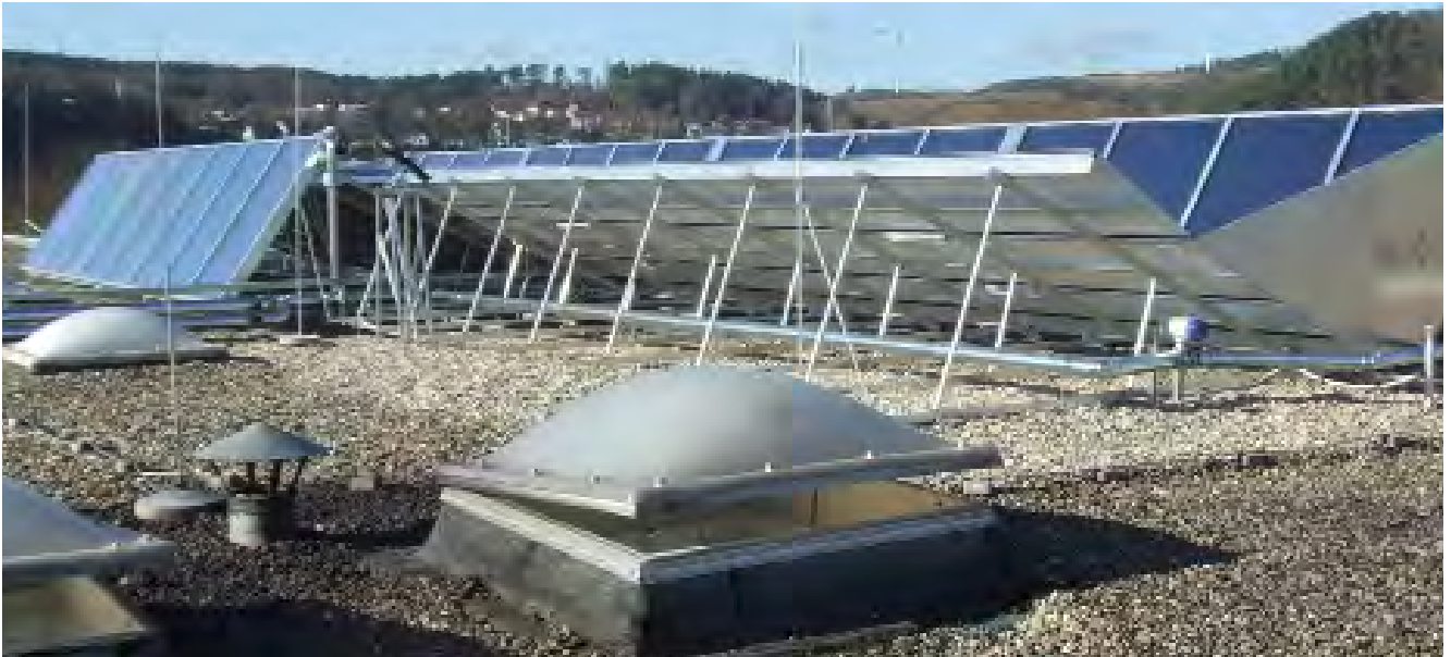
Wäscherei Laguna in Marburg (Lahn) mit Prozesswärme-Flachkollektoren.
