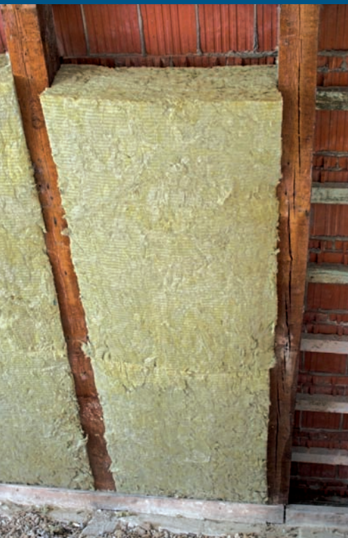
Problematische Stoffe, z. B. FCKW-haltige Dämmstoffe.
