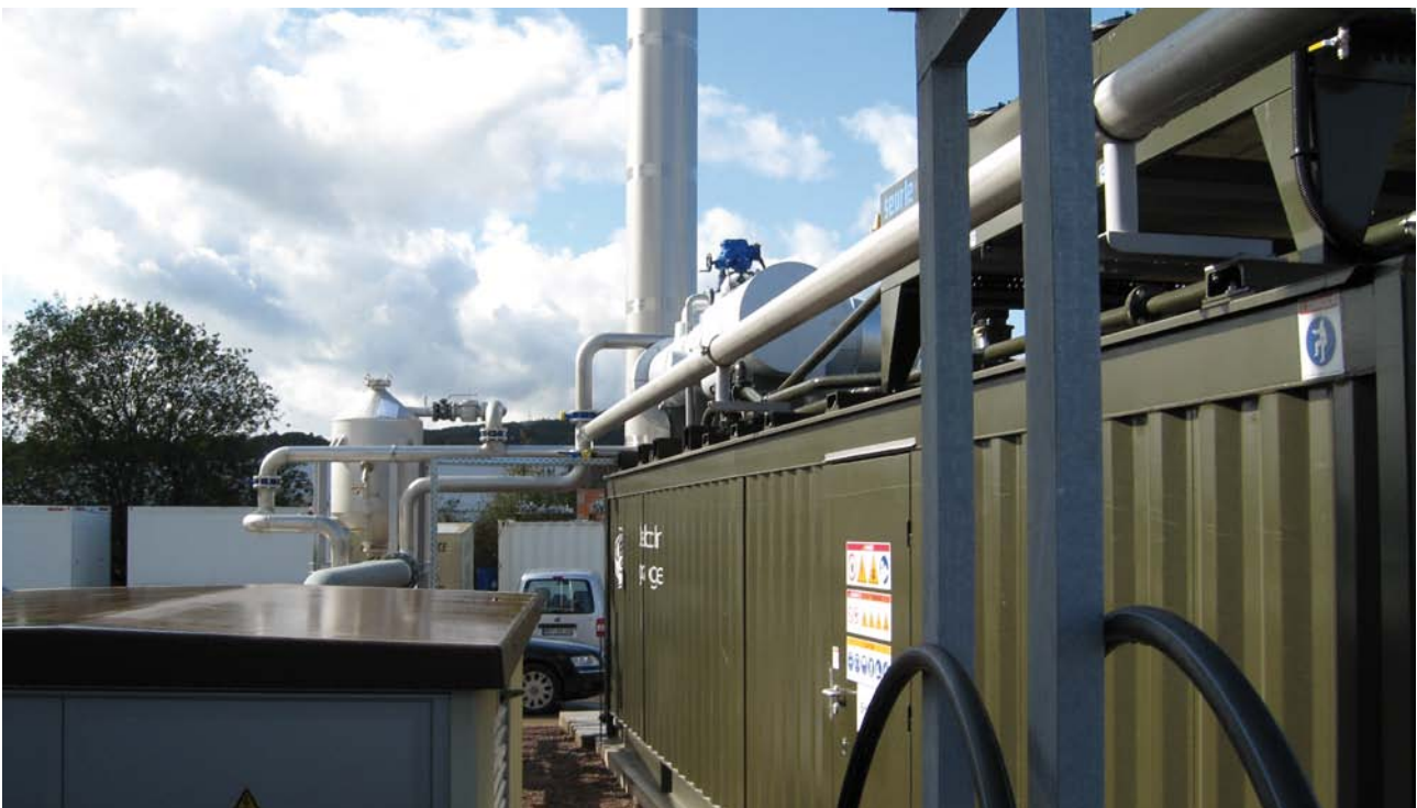
Blockheizkraftwerk einer Vergärungsanlage zur Energiegewinnung
