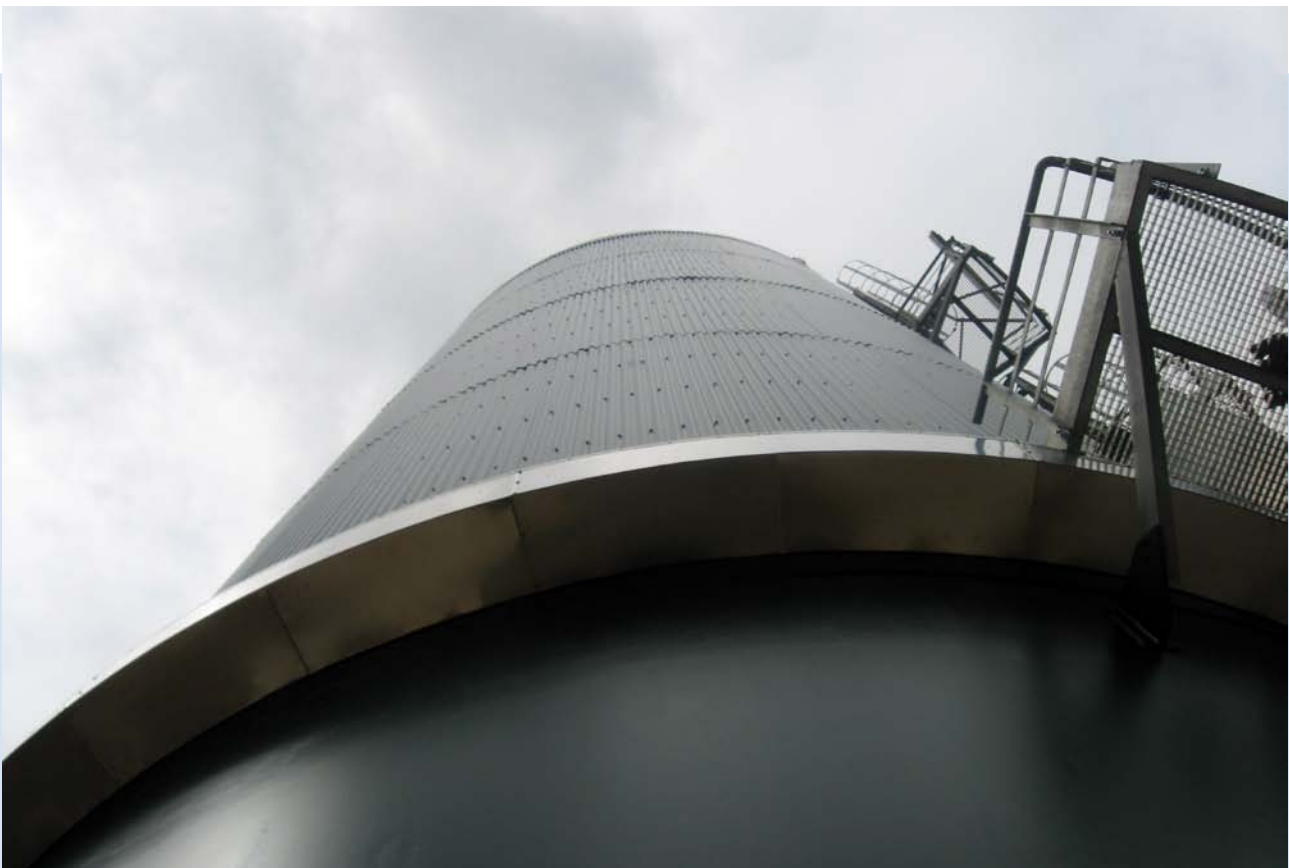
Fermenter einer Biogasanlage
