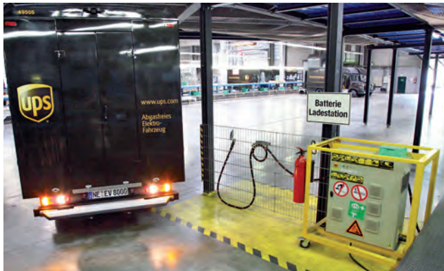
Abbildung 8: Elektrisches Zustellfahrzeug an der Ladesäule © NOW GmbH
