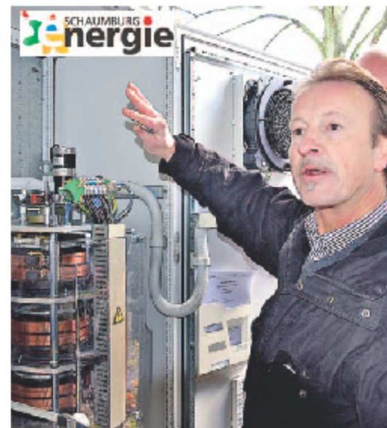
Michael Nienhaus von der Firma Schuntermann zeigt, wie die Spannungsstabilisierungsanlage am Landsberg'schen Hof arbeitet. tbt
